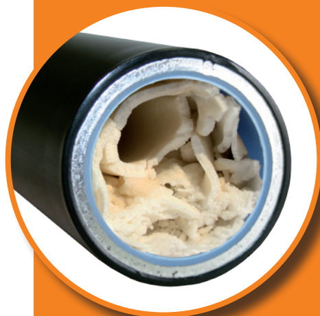
Kalkablagerungen an einer Kunststoff-Rohrleitung
