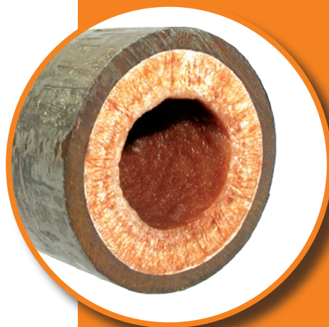
Kalkablagerungen an einer Rohrleitung
