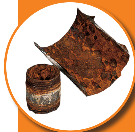
Korrosionen an Rohrleitungen
