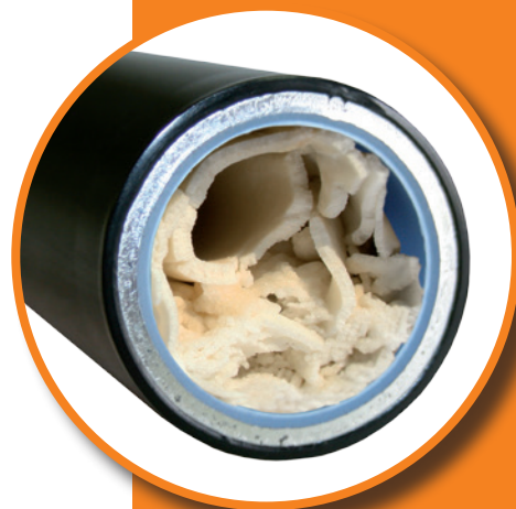
Kalkablagerungen an einer Kunststoff-Rohrleitung
