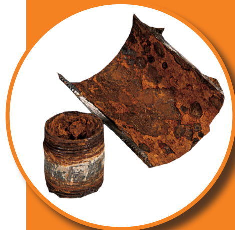
Korrosionen an Rohrleitungen
