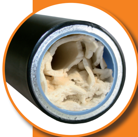
Kalkablagerungen an einer Kunststoff-Rohrleitung
