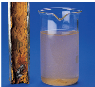
Korrodierte Rohrleitungen, trübes Wasser – ein Hygiene-Risiko
