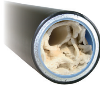
Unhygienisch: verkalktes Verbund- rohrsystem
