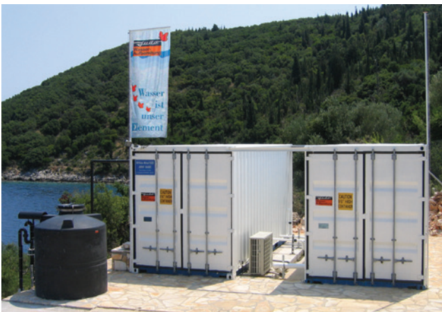
Meerwasserentsalzung in Containerbauweise
