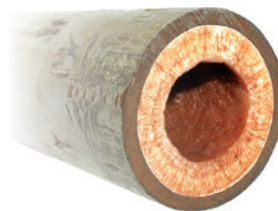
Kalkablagerungen an einer Rohrleitung
